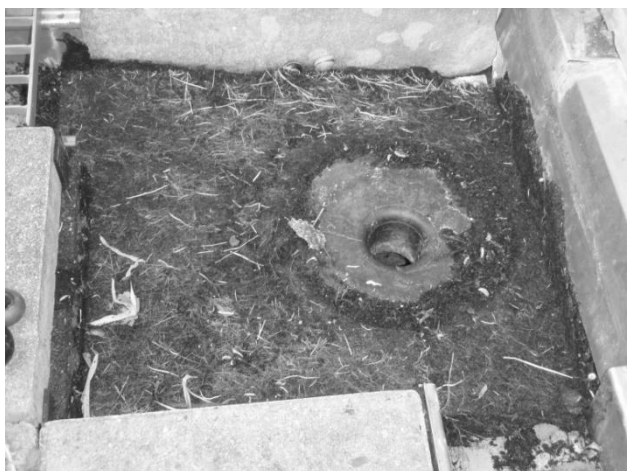
Rødder fra piletræet er søgt ned til afløbet
