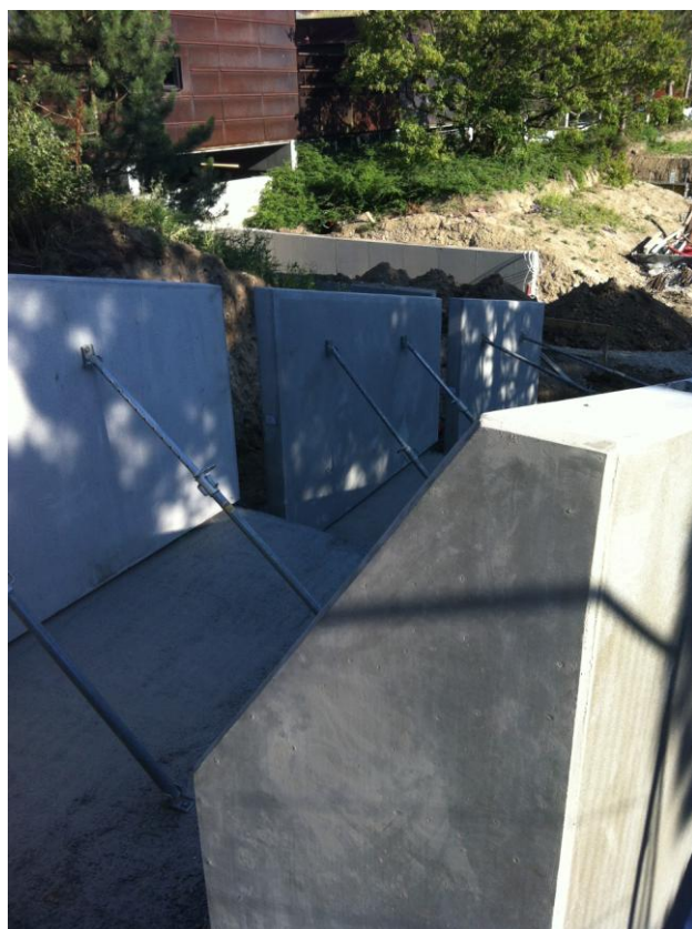
Ved Stenalderplads stien
