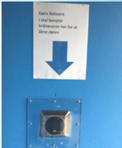
Briklæsere (ved alle indgangsdøre)
