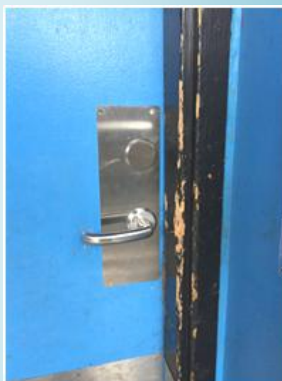
Mekanisk sikring (ved alle indgangsdøre)
