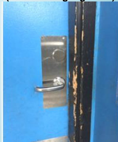
Mekanisk sikring (ved alle indgangsdøre)
