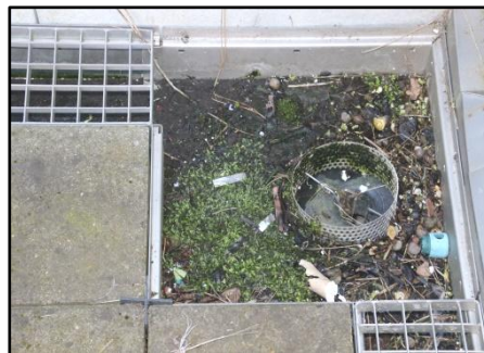
Foto: Hans Laustsen – Løft risten og rens afløbet
