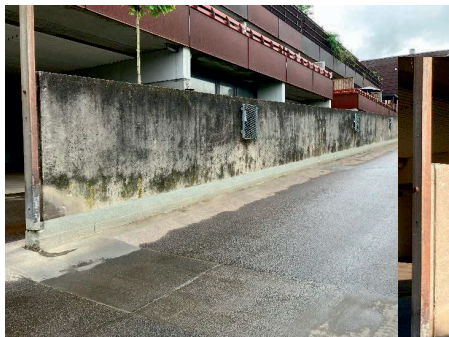
Betonen før afrensning...
